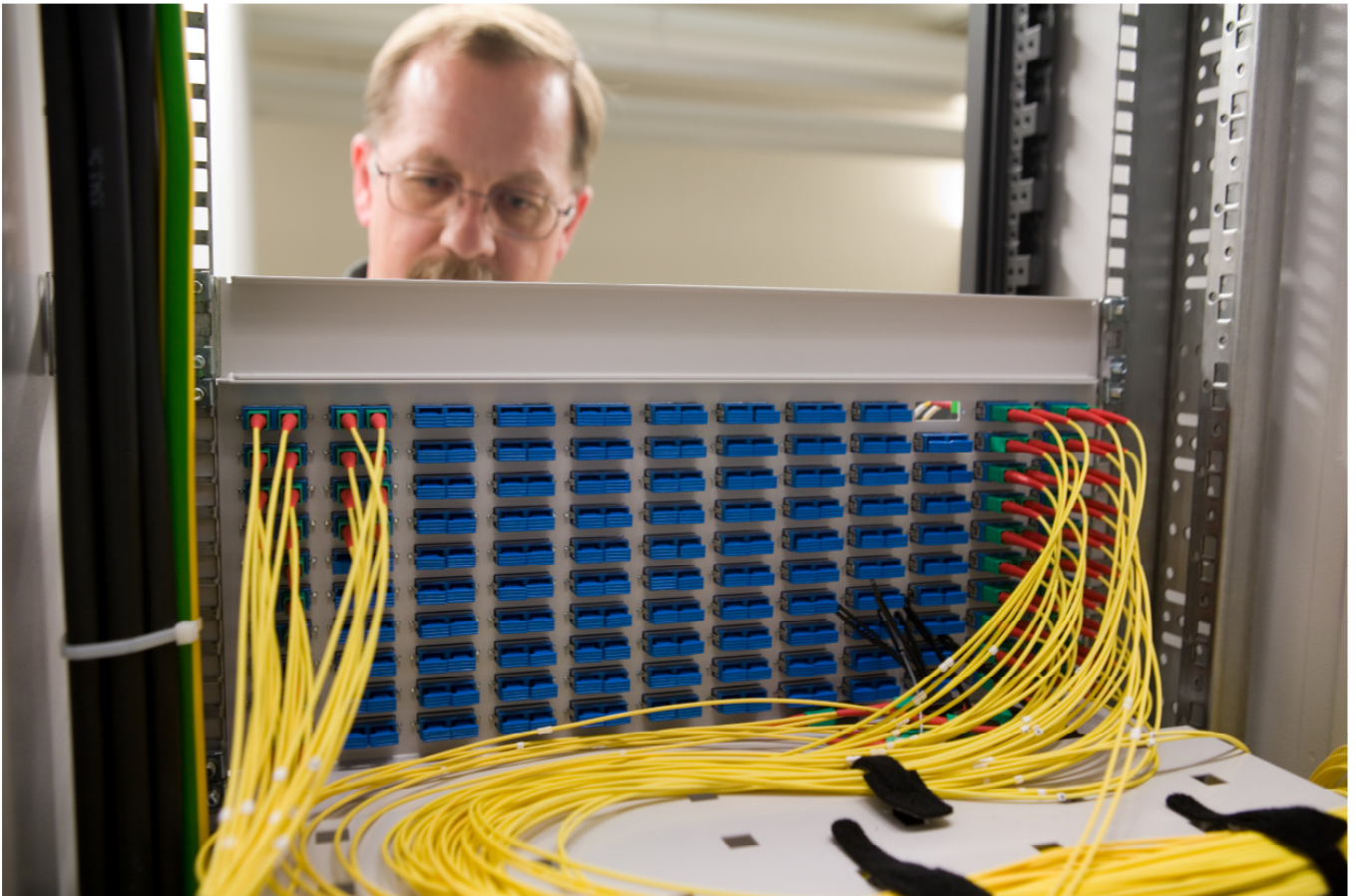
Kommunen, Landkreise und die Region setzen auf den Breitbandausbau
